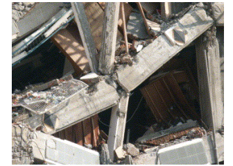
Kirişler kolonlardan daha kuvvetli ise kolonlar mafsallaşır, yapı yıkılır.
