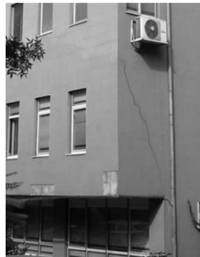
Konsol üzerindeki duvarda çatlaklar
